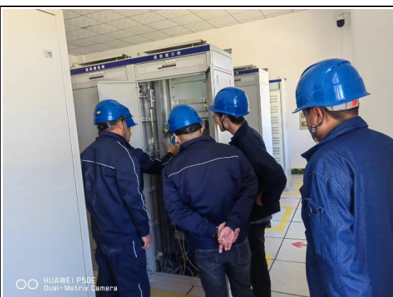
开展安全隐患排查
